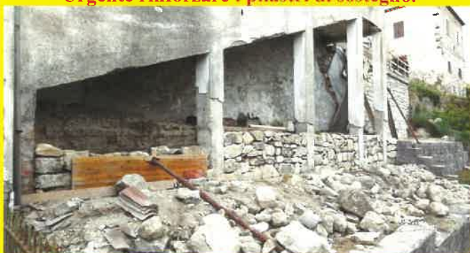
Rinforzare i muri e le fondamenta.
