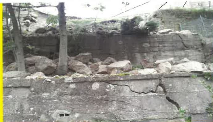
Anche i contrafforti stanno peggiorando!
