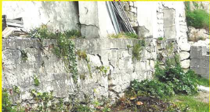
Urgente rinforzare i pilastri di sostegno.
