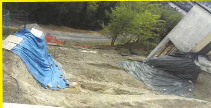
Si fermano i lavori: si teme per la stabilità della Scala.
