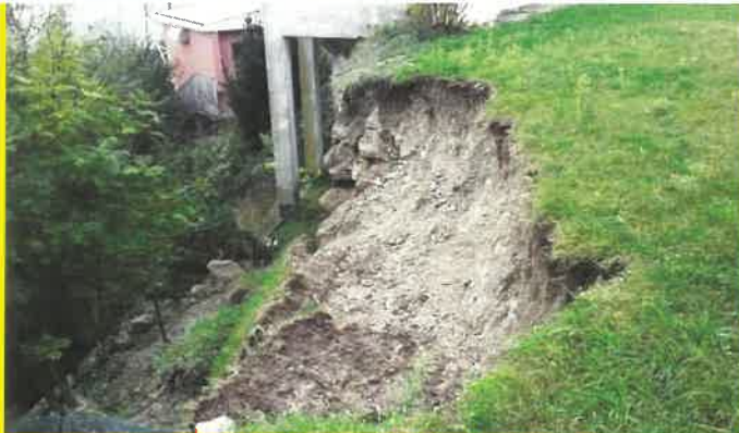
13 Ottobre 2014: la frana vicinissima alla Scala Santa.
