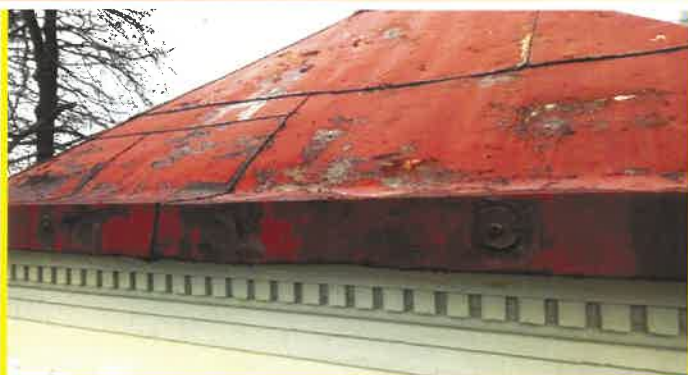
Anche il tetto della XIV Cappella era da sostituire.
